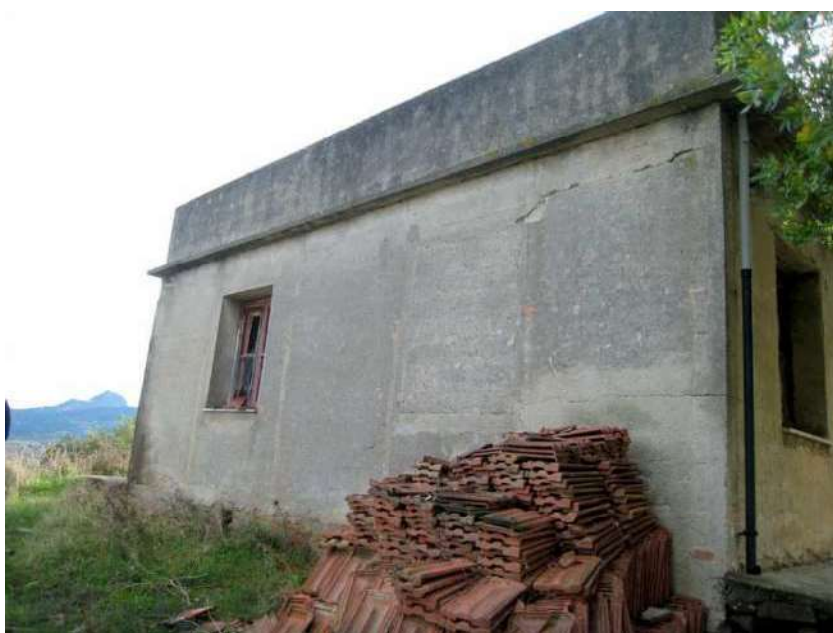
foto n. 127. Lesioni su uno dei prospetti.
