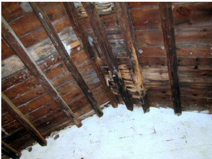
Foto n. 154. Ancora tetti fatiscenti.
