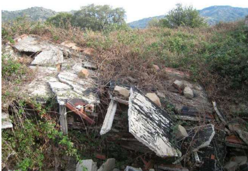
Foto n. 155. Porzioni di tetto già crollate.
