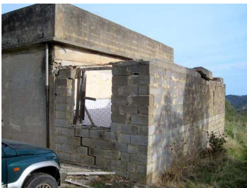
Foto n. 126. Il corpo abusivo quasi del tutto crollato.
