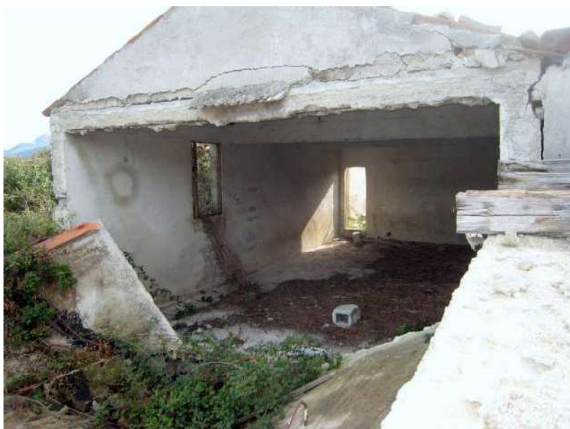
Foto n. 151. Altro tetto crollato.
