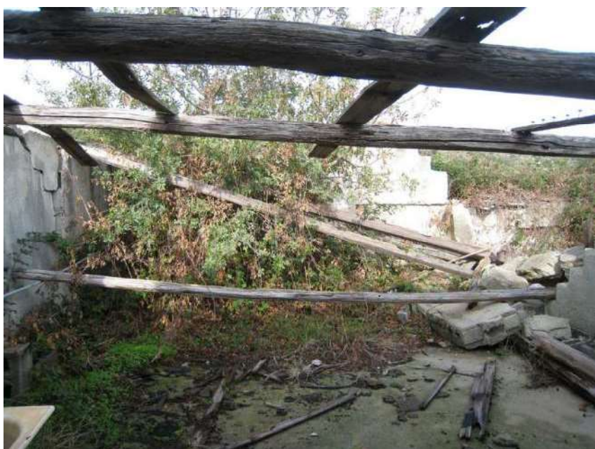
Foto n. 156. Altro tetto crollato.
